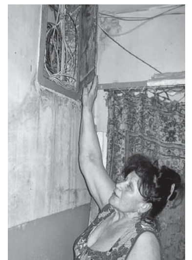
Затекания ставят под угрозу электропроводку на целом этаже.
