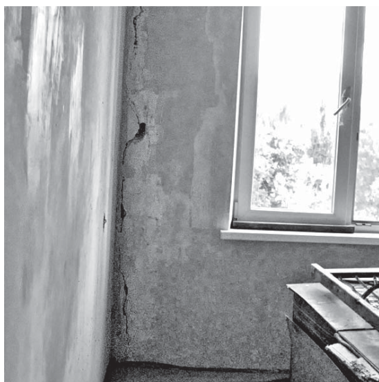
Трещины расплозились в спальне и на кухне.
